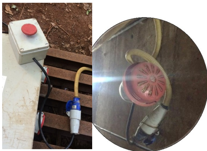
Figura 5: Sirene para indicar a evacuação imediata da galeria
